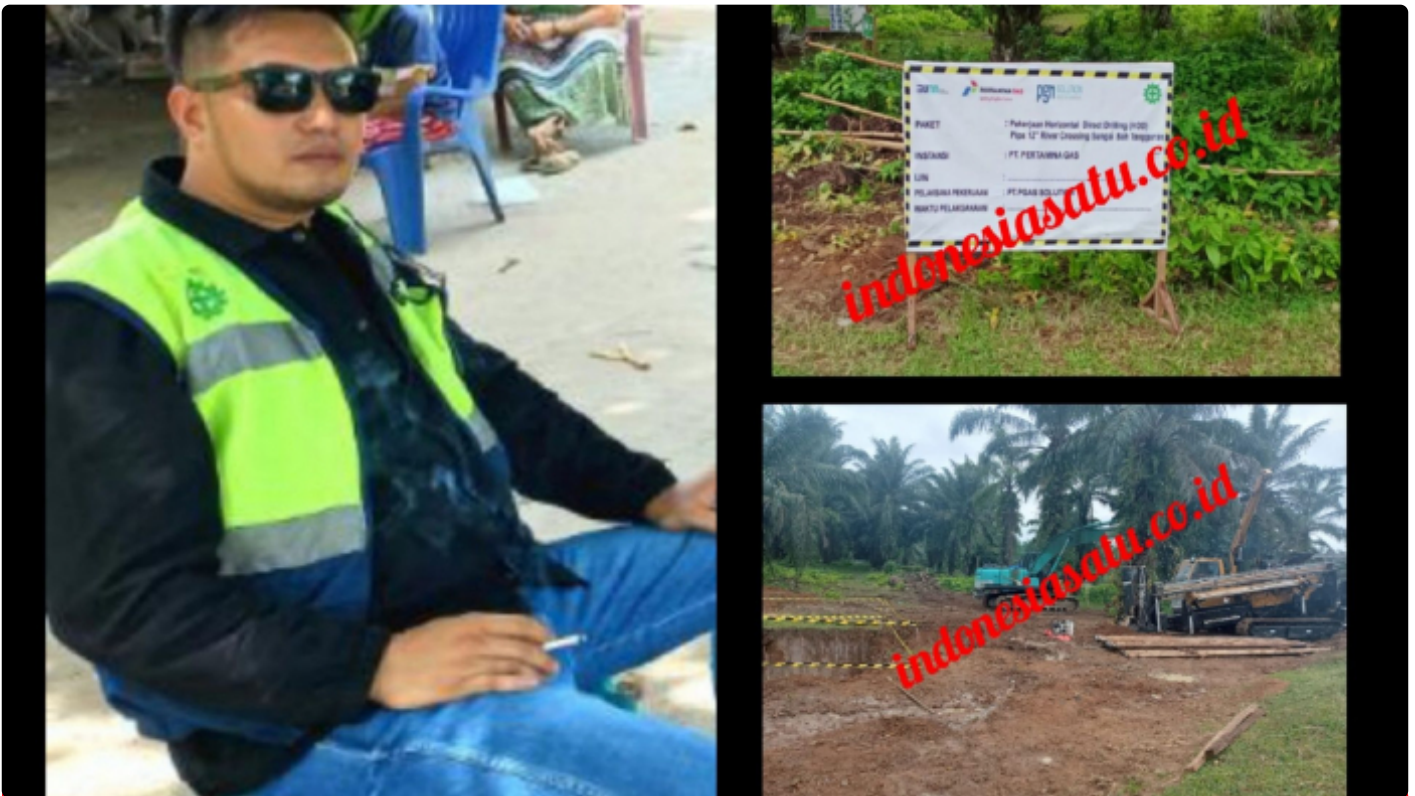
Pengeboran Jalur Pipa Milik PT Pertamina Gas di Sungai Bah Tongguran Dikerjakan PT PGAS Solution
