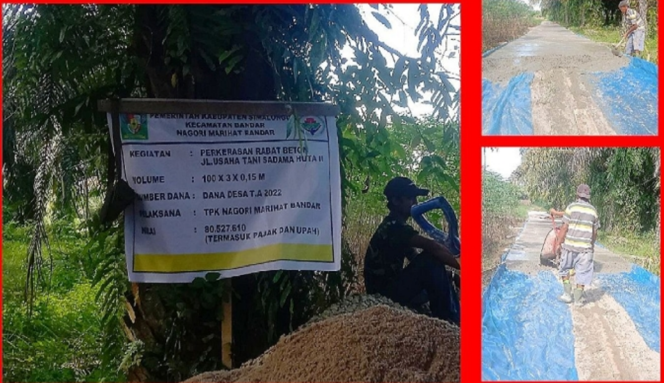
Keterangan Photo : Proses Pengerjaan Perkerasan Rabat Beton di Lokasi Jalan Usaha Tani Sadama, Huta II, Nagori Marihat Bandar, Kecamatan Bandar, Kabupaten Simalungun
